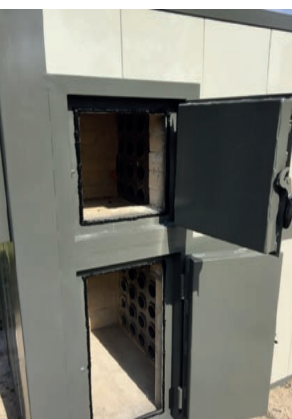
Widok kotta przez drzwi rewizyjne
