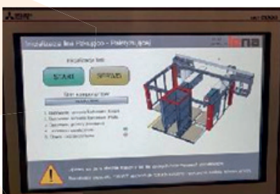
Widok panelu sterowniczego.
